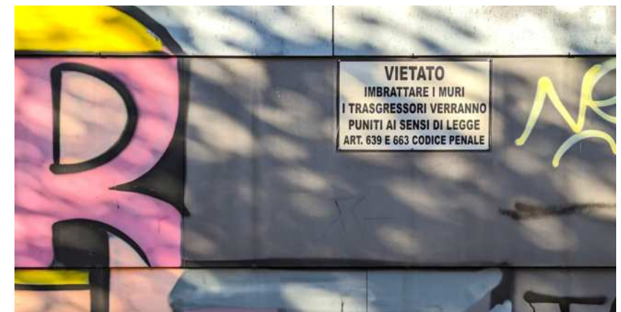
Fig. 4.6 Targa "Vietato imbrattare i muri" su un muro imbrattato
